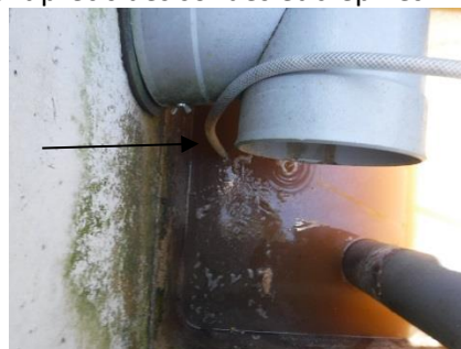
Entrée station, emplacement de la crépine
