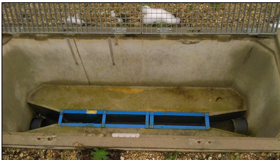
Canal venturi en sortie de station
