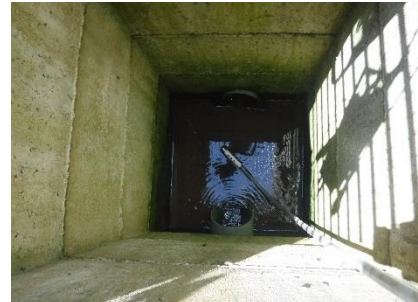
Sortie station, emplacement de la crépine
