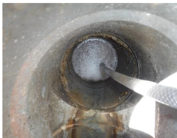
Entrée station, emplacement de la crépine
