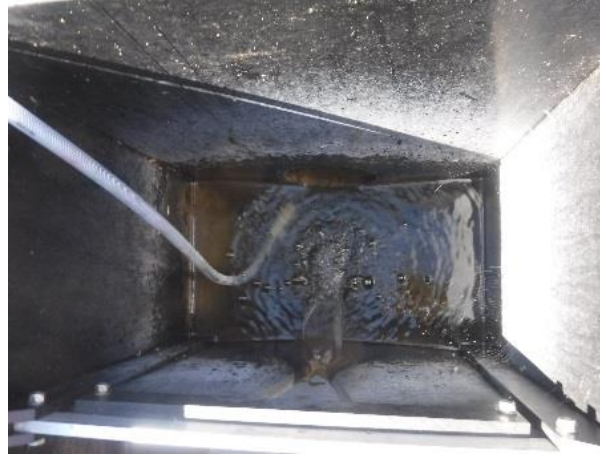
Sortie station, emplacement de la crépine
