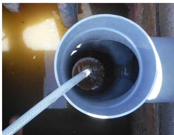
Entrée station, emplacement de la crépine
