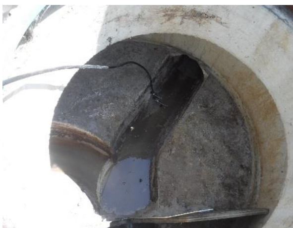
Entrée station, emplacement de la sonde
