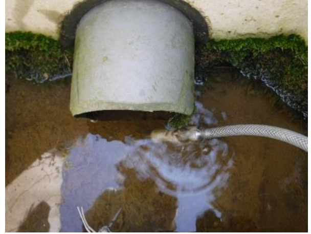
Sortie station, emplacement de la crépine
