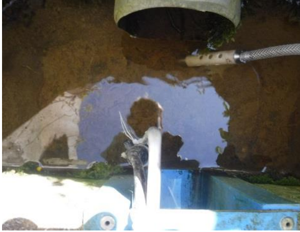
Sortie station, emplacement de la sonde
