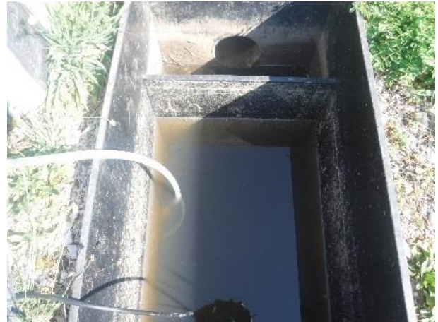
Sortie station, emplacement de la crépine
