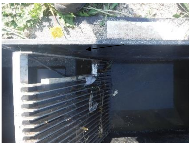
Entrée station, emplacement de la sonde
