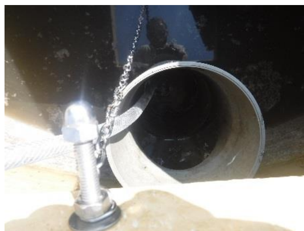
Entrée station, emplacement de la crépine
