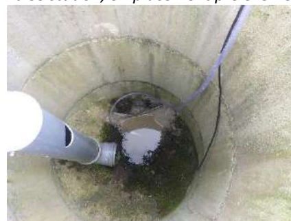
Sortie station, emplacement point de mesure
