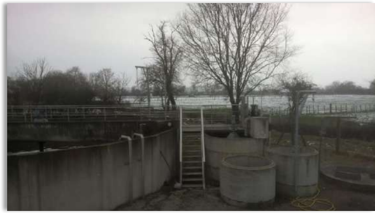
Figure 2: Relevage, Prétraitement et bassin d'aération
