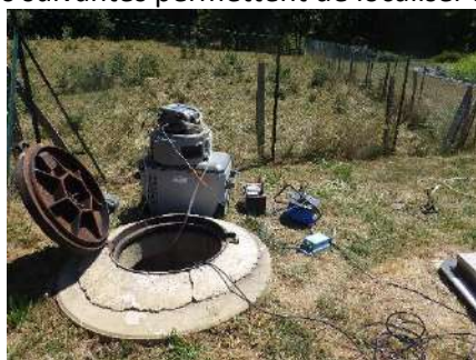
Entrée station, emplacement point de mesures
