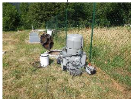
Entrée station, emplacement prélèvement
