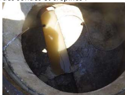
Entrée station, emplacement prélèvement
