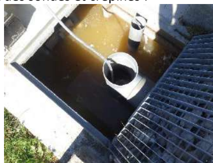
Entrée station, emplacement prélèvement
