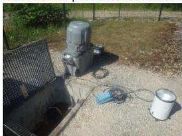
Entrée station, emplacement prélèvement
