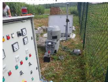
Entrée station, emplacement prélèvement
