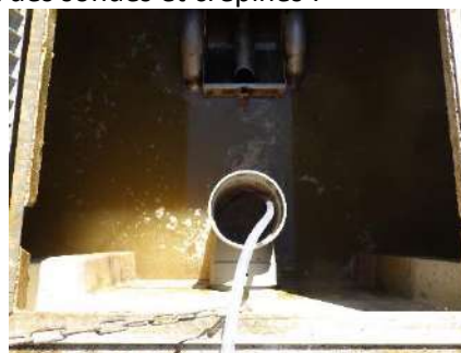
Entrée station, emplacement prélèvement
