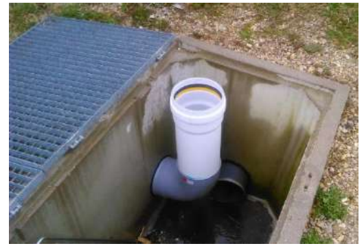
Figure 23: By-Pass avant le dégrilleur
