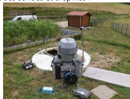
Entrée station, emplacement prélèvement
