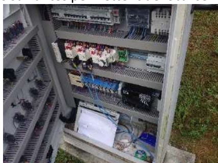
Entrée station, armoire PR
