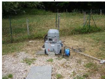
Entrée station, emplacement prélèvement
