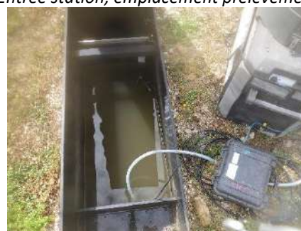
Sortie station, emplacement point de mesure
