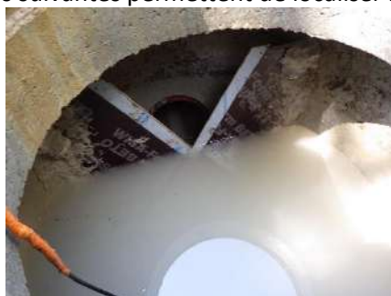
Entrée station, emplacement point de mesures
