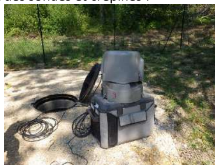
Entrée station, emplacement prélèvement
