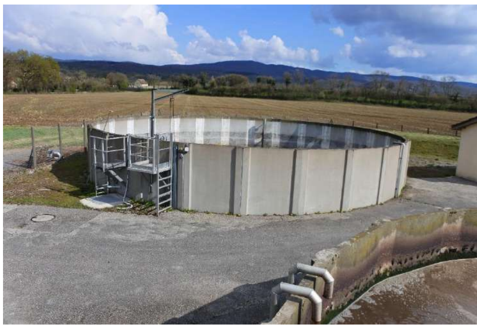
Figure 5: Bassin de stockage des boues liquides
