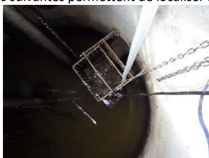
Entrée station, PR1
