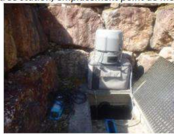
Sortie station, emplacement point de mesure
