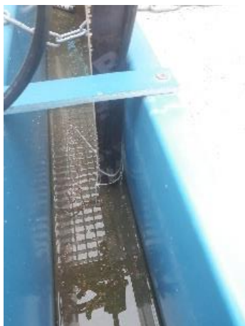
Sortie station, emplacement de la sonde
