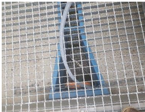
Sortie station, emplacement de la crépine
