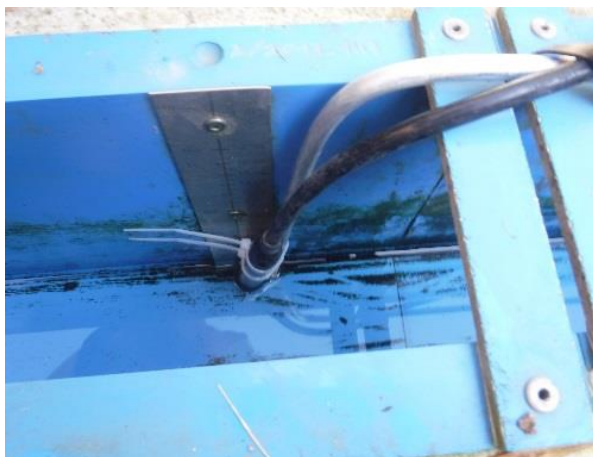
Sortie station, emplacement de la sonde
