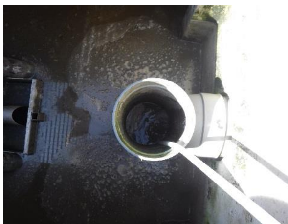
Entrée station, emplacement de la crépine
