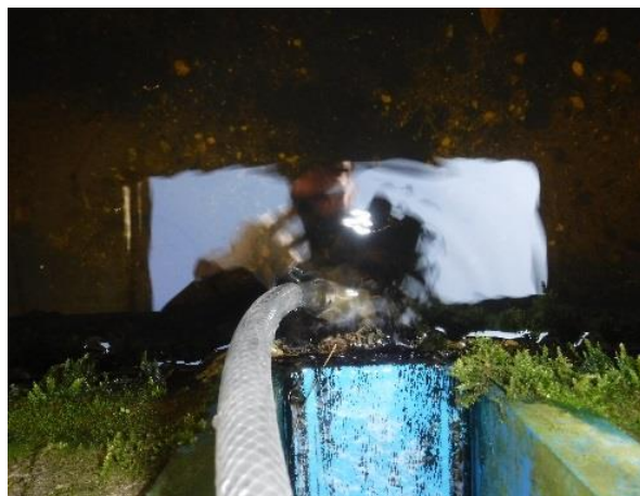
Sortie station, emplacement de la crépine
