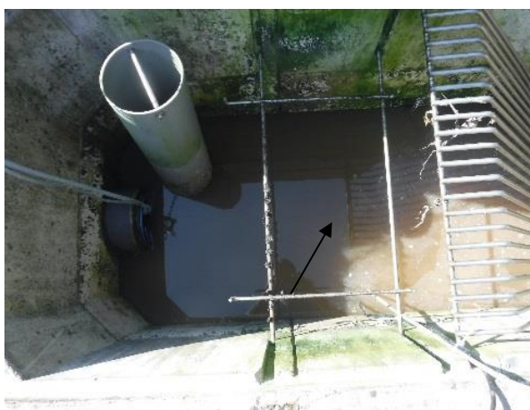
Entrée station, emplacement de la sonde
