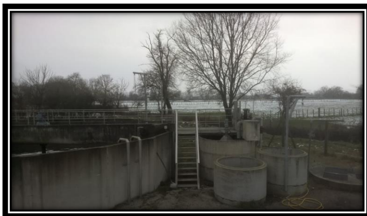
Relevage, Prétraitement et bassin d'aération
