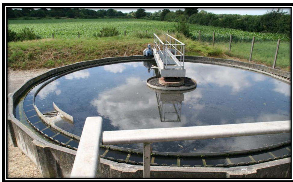
Clarificateur de la STEP
