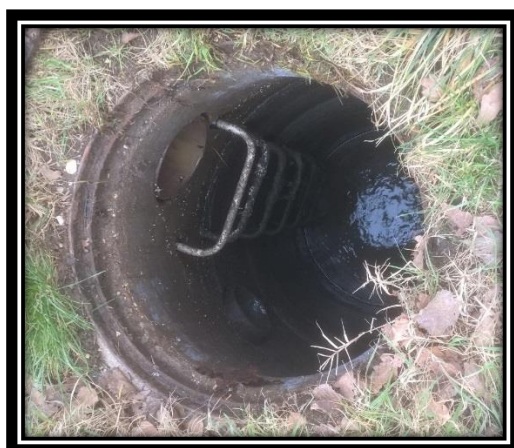
Déversoir en tête de station
