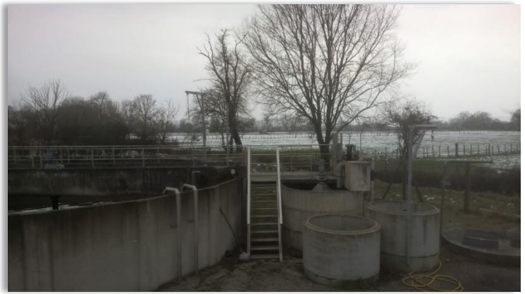
Relevage, Prétraitement et bassin d'aération
